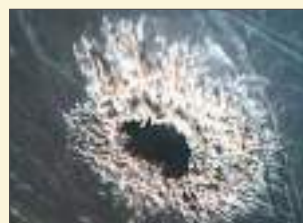
Danno da insetto
