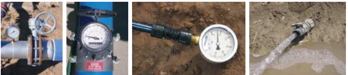
Da sinistra a destra: manometro sulla linea principale, flussometro, manometro sulla manichetta, controllo acqua di spurgo.
